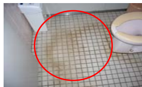
トイレがくさい、汚い
