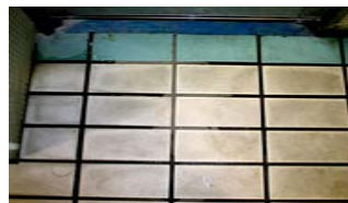
プール。浴室の床が滑り危険
